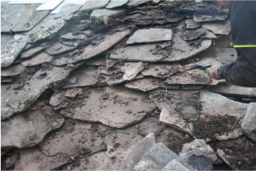
Nærstudie av lekkasjepunkt. Svakheita til denne tekkinga er knekte og sprekte heller.
