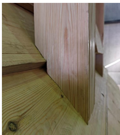
Bilde 73 Underkanten av svilla mellom stavene stikker 1 cm utenfor kanten på stavene.
