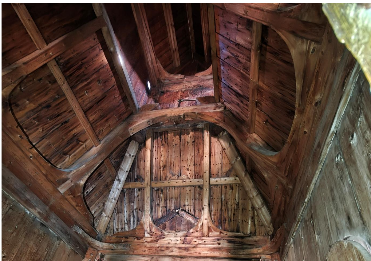
Bilde 61 De fleste svarte prikkene på bildet er tjære som trekker inn gjennom plugghullene til spona.
