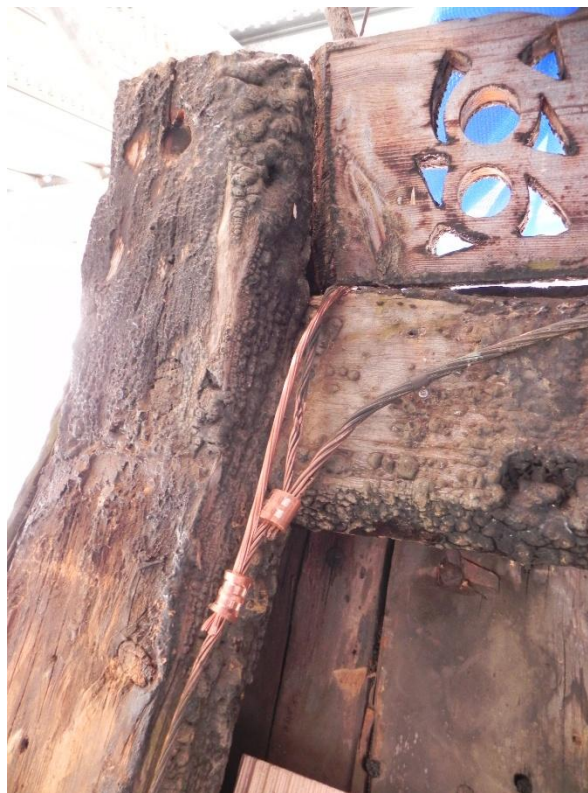
Bilde 65 Sammenfellingen av vindski/isbord, mønekjøl, og mønekam. Dragehodet er tatt ned, men en ser hvordan en plugg har låst dragehodet på plass. Foto Hans Marumsrud
