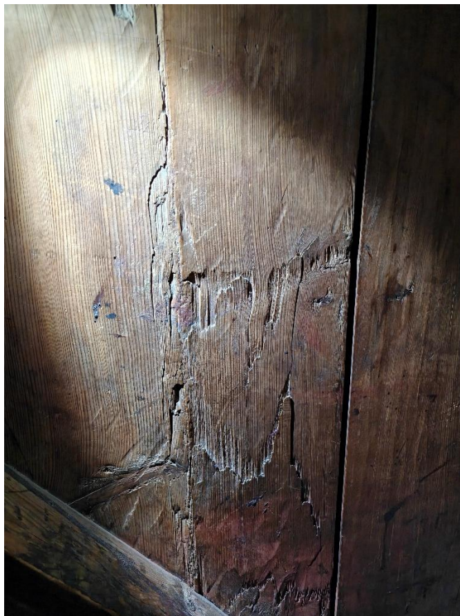
Bilde 28 Utrivninger som ikke har blitt hogd bort på innsiden av en veggtil i Borgund.
