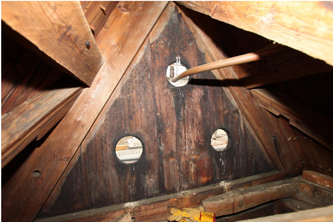
Gavltrekanen i takrytteren i Borgund. Det er et tjærelag på innsiden som ikke er påført etter oppføringen av takrytteren. Langs sperrene er tjærelaget hogd bort i fasingen av tilene. Foto: Hans Marumsrud.
