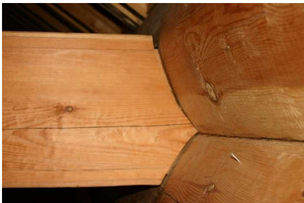
Gliper mellom bete og veggstokkar på grunn av trykk frå taket. Foto: Atle Ove Martinussen
