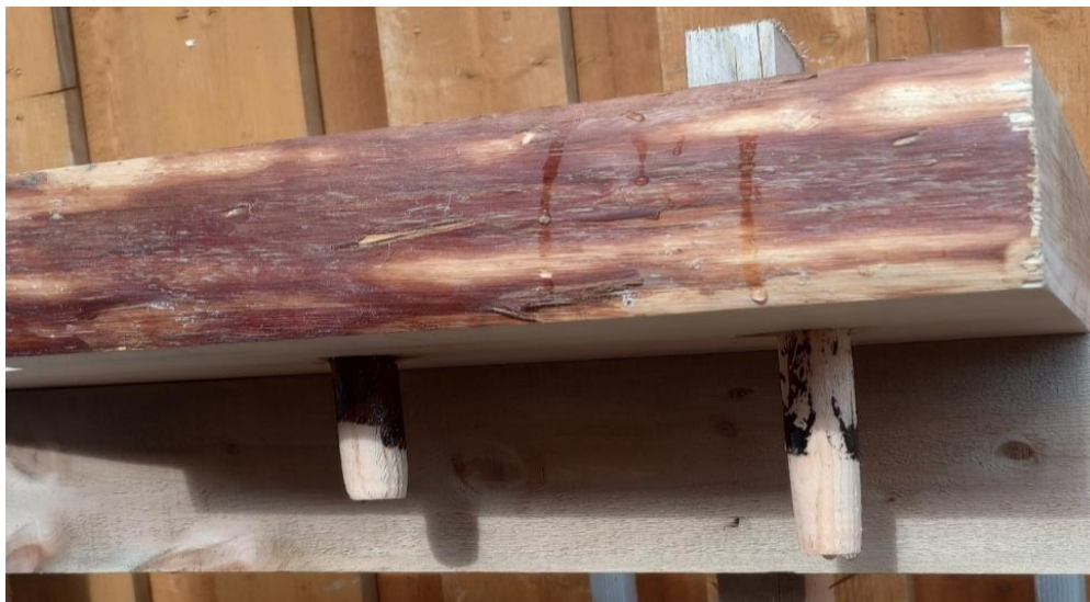
Kubben er hula ut og fylt med vann. Vi ser at det drypper vann fra testnaglene.
