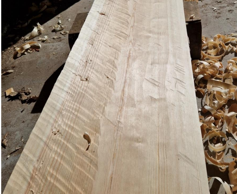
Bilde 26. Skavling av en av svillen. Foto Åsmund Stormoen.
