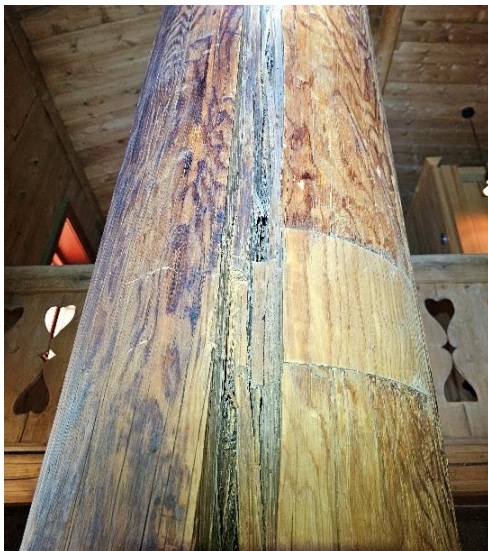
Bilde 17. Tørkesprekken har slått inn i tilesporet. Tørkesprekken tar korteste vei til marginen, og dette viser tydelig at staven er hogd i ferskt virke. Bildet er fra Høre stavkirke i Valdres. Foto Åsmund Stormoen
