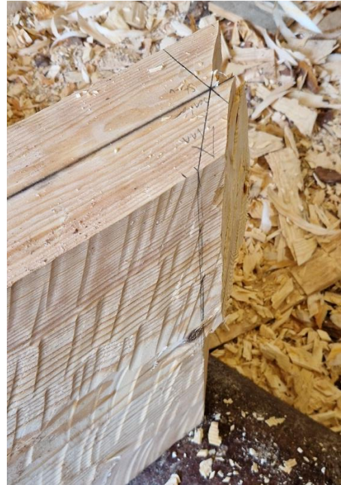
Bilde 31. Hogging av gjæring. Den vinkelrette streken over sentermerket markerer hvor senter av staven havner. Foto Åsmund Stormoen.
