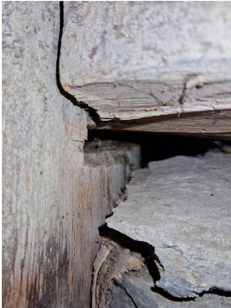
Bilde 30. Hulrommet under svillen i staven, hullet er ikke like bredt som svillen på yttersiden. Foto Åsmund Stormoen.
