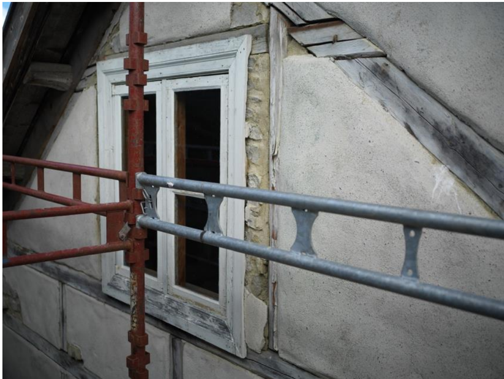
Bildet over viser noe av skadeomfanget der pussens hang bare på ved hjelp av treverket/bindingsverket.
